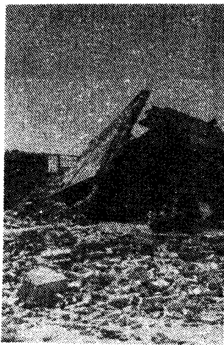
تصویر شماره ۱۱. فروریختن کامل سقف در اثر عدم پایداری دیوارها
