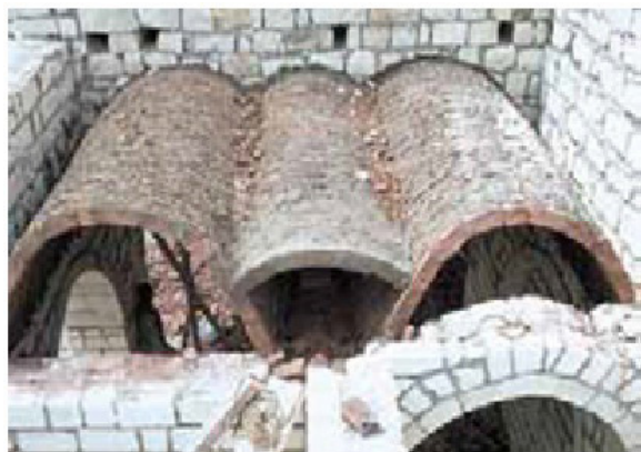
تصویر ۶- پروژه‌ی گورنای جدید؛ ساخت با استفاده از مصالح بومی و فناوری بومی. (Serageldin, 2007, 46) ماخذ:
